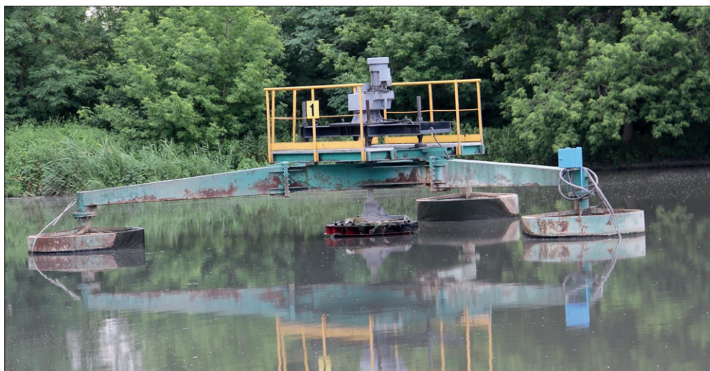
Aerator na stawach biologicznych w starej oczyszczalni ścieków, źródło: Saur Konstancja
